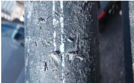
PE 100 pipe failures
